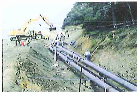
TUBES FW DE SÉCURITÉ DN 100/125 et DN 300/350, 3600 m, transportant du kérosène et du gazole
